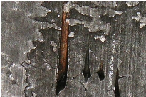
Рис. 4. Руйнування покриття на ділянках ерозії
