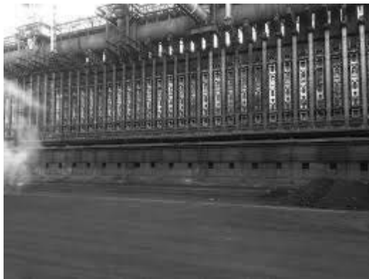
Рис. 1. Коксовая батарея (общий вид)
